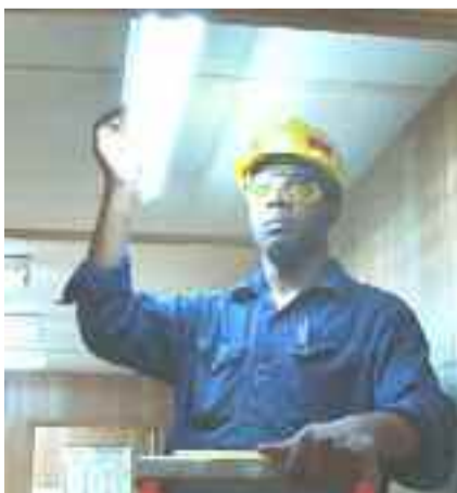
● Funcionário da Jamalco instala lâmpada LED: redução de 33% nos custos com iluminação
