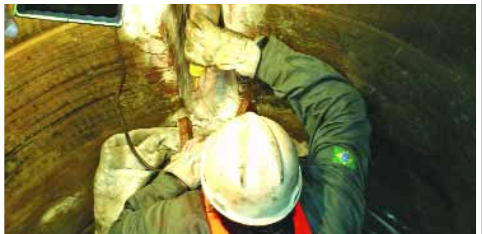
SEGURIDAD | El mantenimiento anual de la Prensa 3.500 reparó una resquebrajadura en el equipo
