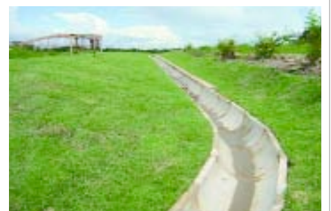
> BUENAS PRÁCTICAS | Canaleta de drenado para almacenamiento de productos químicos y manipulación de residuos peligrosos, eliminando los riesgos de contaminación, ampliación de recursos para atención de emergencias ambientales en el área del puerto, tales como flotadores de concentración de petróleo y reducción de residuos, como la eliminación del uso de vasos plásticos y la adopción de papel reciclable al 100% en las oficinas.
